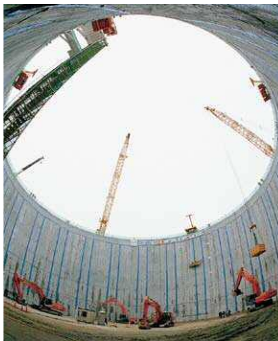
仙台LNG基地新港工場
